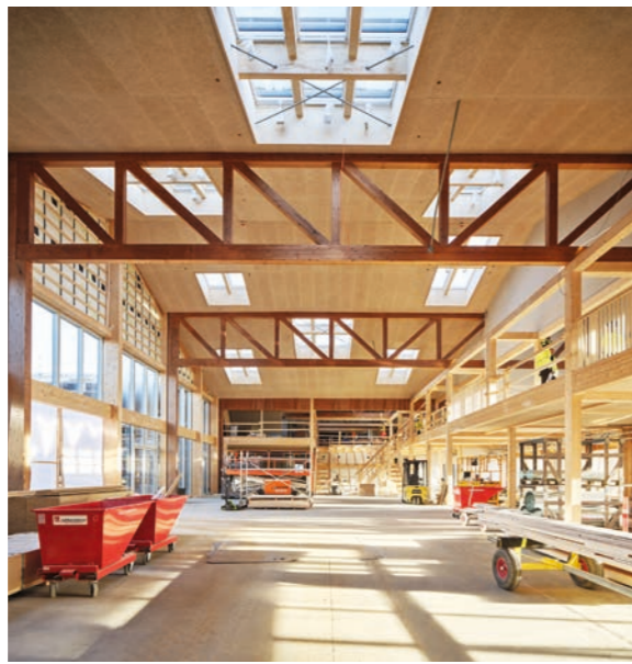
▲ Der Umbau der Lagerhalle zum LKR Innovation House schreitet voran. Die dunklen Holzelemente zeigen die tragenden Holzbalken aus dem 30 Jahre alten bewahrten Bestand
